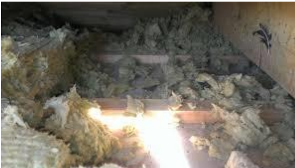
Obrázok 1: Príklad škody spôsobenej kunou - zničenie tepelnej izolácie,
